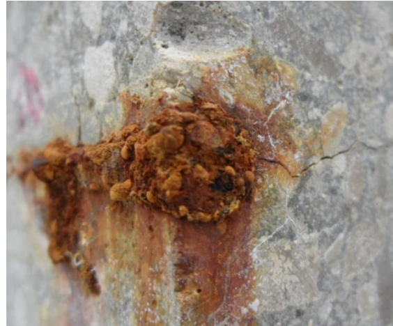
b) Rebar corrosion
